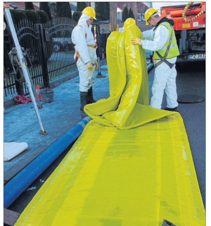
Modernizacja sieci kanalizacyjnej – umieszczanie rękawa światłoutwardzalnego w kanale, który niweluje nieszczelności odcinków rurociągu
