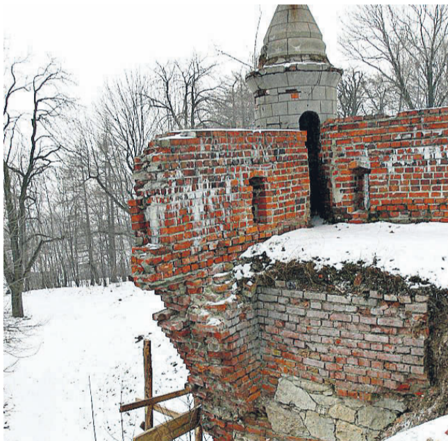
Naróżnik muru z wieżyczką wymaga natychmiastowych zabezpieczeń
